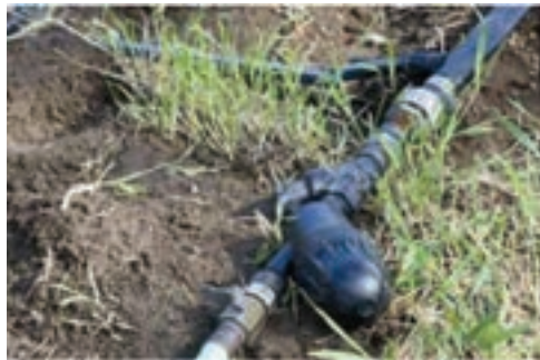
الف) فیلتر در مسیر شبکه آبیاری
