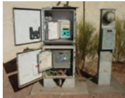
الف) تجهیزات کنترل برق مرکزی سیستم آبیاری
