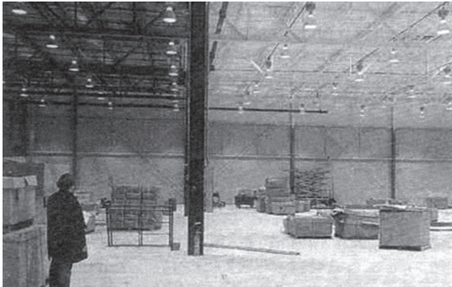
شکل ۲۴-۳- سیستم روشنایی عمومی
