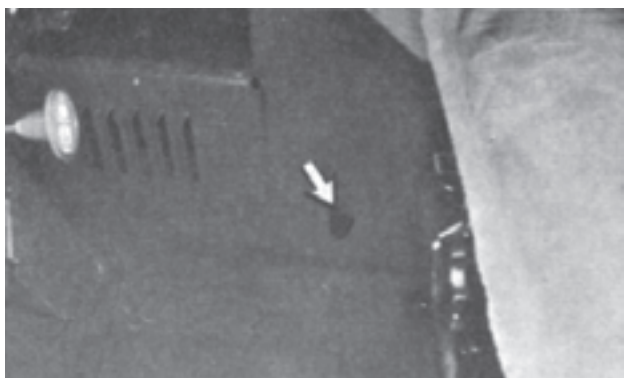
شکل ۲۱-۴-۱- کلید کنترل حرارت بخاری کف اتاق راننده
