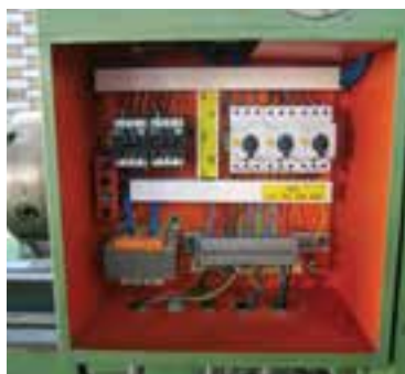
(ب) نمونه کاربردی در تابلوی برق دستگاه تراش
