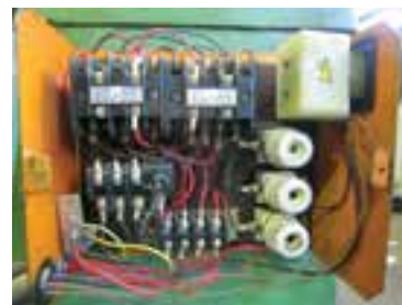
شکل ۵-۹۱ نمونه تابلوی برق دستگاه تراش
