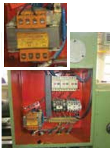
شکل ۴-۱۳ ترانسفورماتور در تابلوی برق دستگاه تراش.
