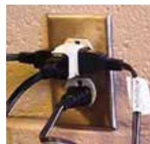
شکل ۲-۱۷ انشعاب غیر استاندارد از پریز برق.
