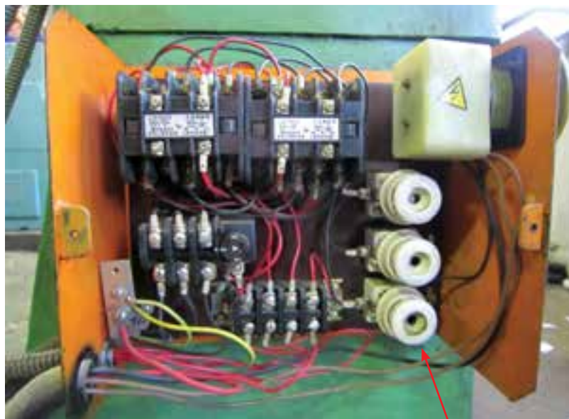
(الف) تابلو برق ماشین تراش
