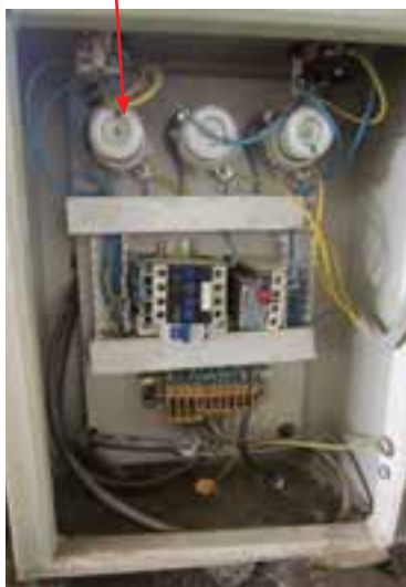
(ب) تابلو برق اره لنگ
