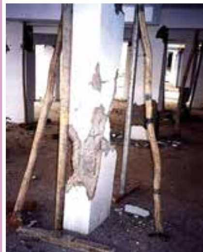
بتن نامرغوب و فاصله ی زیاد خاموت ها باعث این خرابی شده است.
