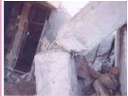
شکست ستون به علت فاصله‌ی زیاد خاموت‌ها و بتن‌ریزی نامناسب و سطح مقطع کم آرماتورهای طولی که به دنبال آن کل سازه تخریب شده است.
