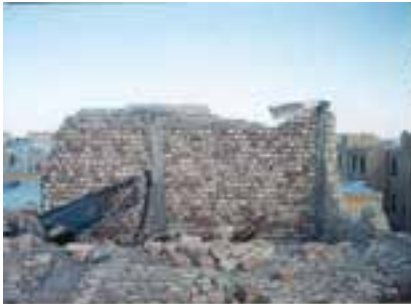
عدم رعایت طول مهاري مناسب در شناژ قائم و عدم اجرای کلاف افقی زیر سقف
