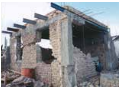
کیفیت نامطلوب بتن، عدم اجرای صحیح شنآزهای افقی و قائم و اتصالات آنها موجب تخریب این سازه ی سبک و ساده شده است.
