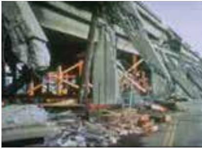
تخریب ساختمان به دلیل ضعف طراحی و تشکیل طبقه‌ی نرم
