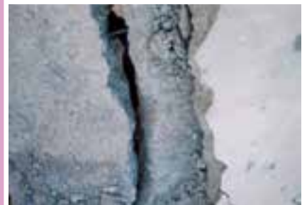
ایجاد ترک در سقف تیرچه بلوک به دلیل کیفیت نامطلوب بتن و عدم قرار دادن کلاف در سقف تیرچه بلوک می باشد. وجود کلاف عرضی در سقف می تواند صلبیت و یکپارچگی سقف را حفظ کند.
