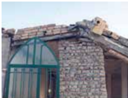
قطع شناژ افقی در محل اتصال با نعل درگاه و بتن نامرغوب موجب ایجاد خسارت به سازه و تخریب قسمتی از آن شده است.
