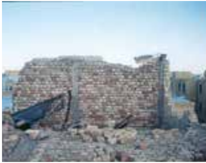
عدم رعایت طول مهاري مناسب در شناژ قائم و اجرا نکردن کلاف افقي زیر سقف
