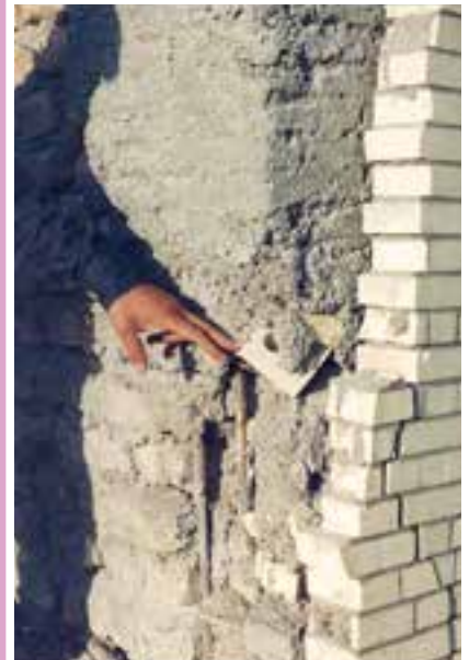
استفاده از پاره آجر در شناژ عمودی به جای بتن و بتن‌ریزی با مصالح نامرغوب
