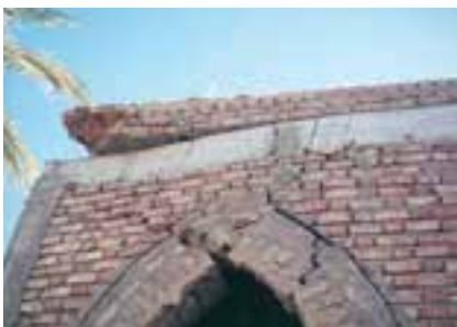
کیفیت نامرغوب بتن و فاصله‌ی زیاد شناژهای قائم موجب ایجاد خسارت در این سازه شده است.
