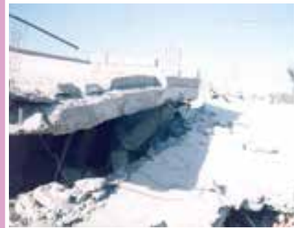
شکست ستون از محل درز اجرایی
