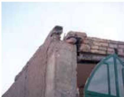
عدم اجرای شناژ افقی بالا و اتصال نادرست تیر
