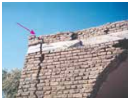
عدم رعایت ارتفاع شناز عمودی و فاصله‌ی آن‌ها از یکدیگر موجب شکاف شده است.
