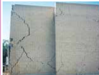
آسیب دیدگی شناز قائم و ایجاد ترک در ساختمان اورژانس
