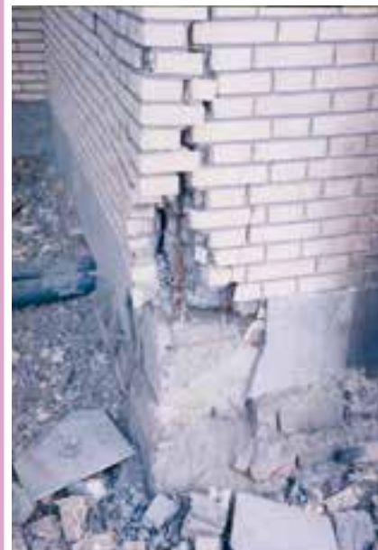
بتن‌ریزی نادرست شناژ قائم
