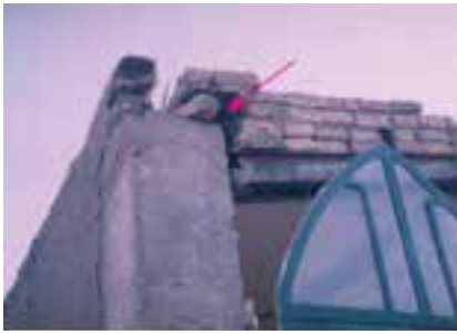
عدم وجود شناژ افقی موجب تخریب سازه شده است.
