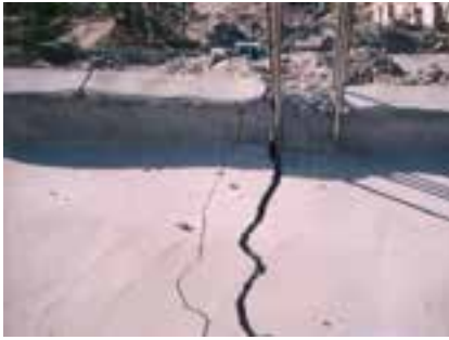
ترک ایجاد شده در سقف یک سازه‌ی بتنی در راستای تیر
