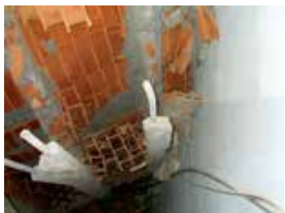
عدم اتصال مناسب تیرچه‌ها با تیر اصلی، موجب جدا شدن آن‌ها از تیر و به تبع آن فرو ریختن سقف شده است.
