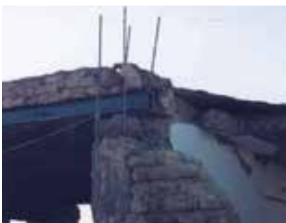
عبور آهن نعل درگاه از شناز و عدم بتن‌ریزی در آن نقطه که باعث خرابی گردیده است.
