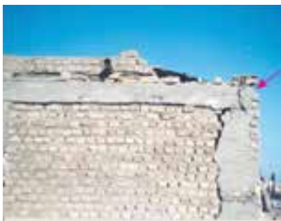
عدم اجرای صحیح شناژهای افقی و قائم و بتن‌ریزی ناصحیح شناژ موجب شده تا شناژهای قائم و افقی کاملاً از هم جدا شوند.
