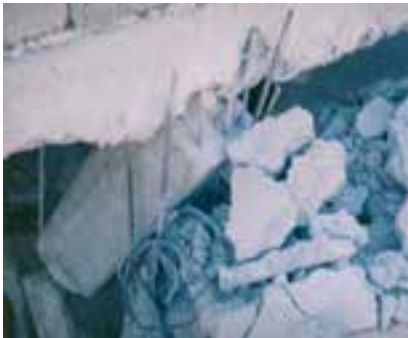
تخریب کامل ستون بتنی در برابر نیروی زلزله
