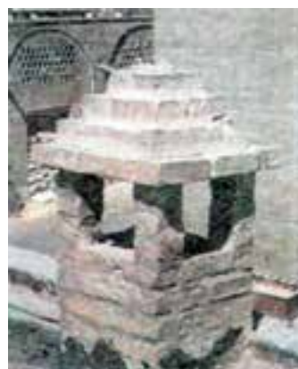
شکل ۳-۶- دودکش و هواکش در ساختمان
