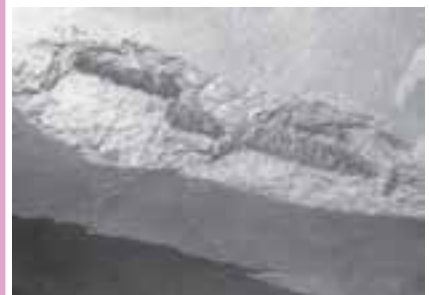
ترک خمشی ایجاد شده، در اثر میزان کم طول وصله ی میل گردهای کششی اصلی
