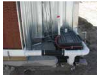
تصویر ۱۲-۲- پمپ و لوله های توزیع آب
