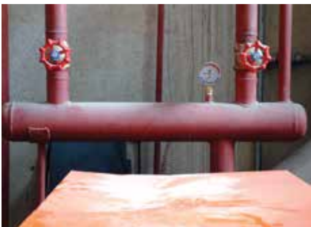
شکل ۳۲-۵- استفاده از اتصال جوشی در حرارت مرکزی
