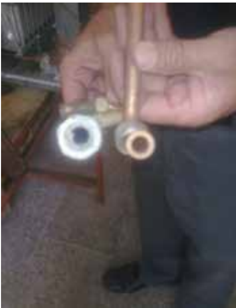
شکل ۱۲-۵- تشکیل رسوب در لوله آب گرم
