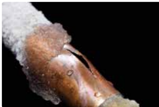
شکل ۶-۵- شکستن لوله آب در اثر انجماد آب
