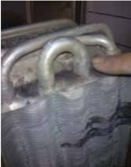
شکل ۱۱-۵- تشکیل رسوب در آب گرم‌کن
