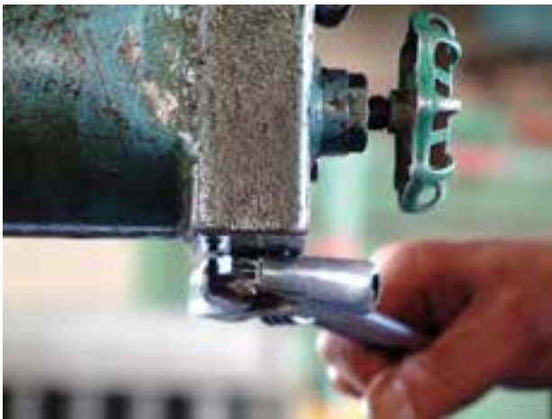
شکل ۱۴-۳- باز کردن درپوش تخلیه ی روغن
