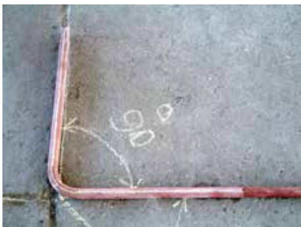
شکل ۳-۵۷- لوله‌ی خم کاری شده
