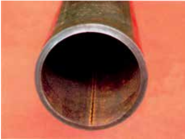
شکل ۱۳-۲- لوله‌ی برقو خورده
