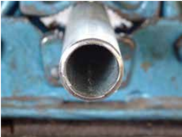
شکل ۲۰-۲- لوله‌ی برقو خورده
