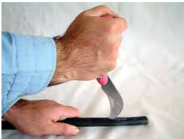
الف - نحوه‌ی غلط لخت کردن کابل
