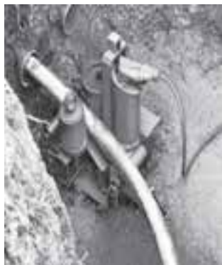
شکل ۵-۵۱- دستگاه کشش کابل
