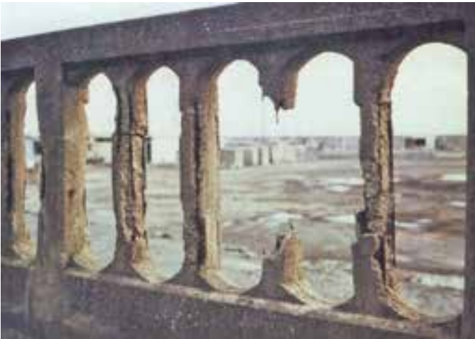
شکل ۷-۵- سازه بتنی در اثر عوامل محیطی دچار تخریب گردیده است.
