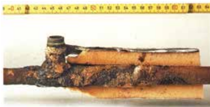
شکل ۱۵-۷ خوردگی موضعی لوله فولادی در زیر عایق حرارتی (پشم شیشه)
