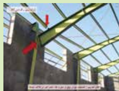
برش در پیچ‌ها، باعث گسیختگی اتصال در زمان زلزله شده است
