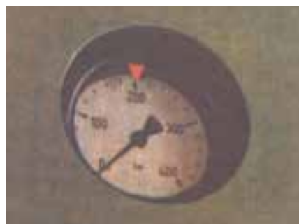
شکل ۲-۵۷ کنترل فشار روغن هیدرولیک
