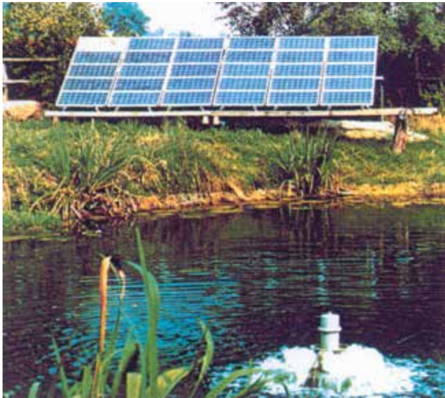
شکل ۷-۱۸- کاربرد پمپ‌های خورشیدی - تا سال ۱۹۹۷ میلادی در حدود ۲۰۰۰۰ پمپ خورشیدی در جهان نصب و راه‌اندازی شده است. در این پمپ‌ها انرژی خورشیدی به انرژی الکتریکی DC یا AC تبدیل می‌شود. توان کارکرد پمپ‌های فتوولتائیک به مقدار انرژی خورشیدی در منطقه بستگی دارد.
