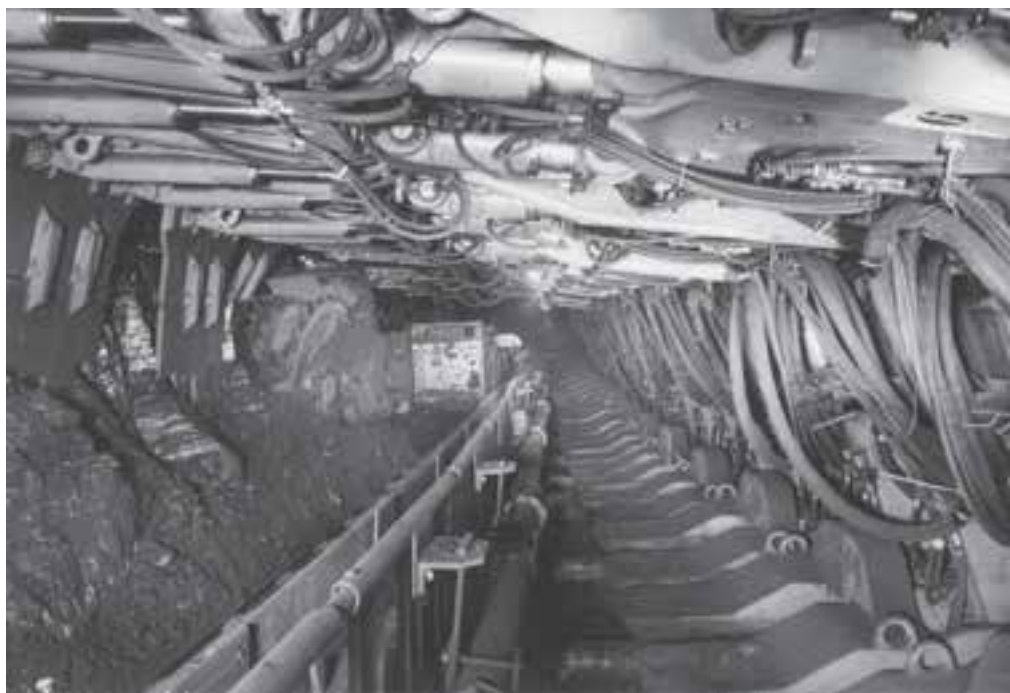
شکل ۹-۲۰- پایه قدرتی در کارگاه استخراج
