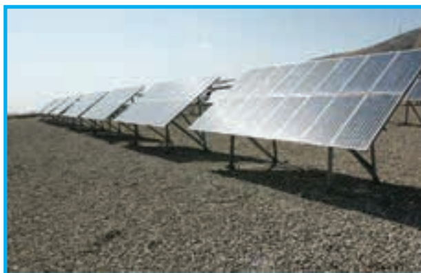
شکل ۱۰-۳ یک نیروگاه فتوولتاییک
