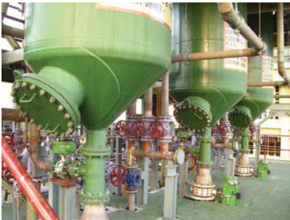
شکل ۴-۳- بخشی از کارخانه کلر آلکالی
