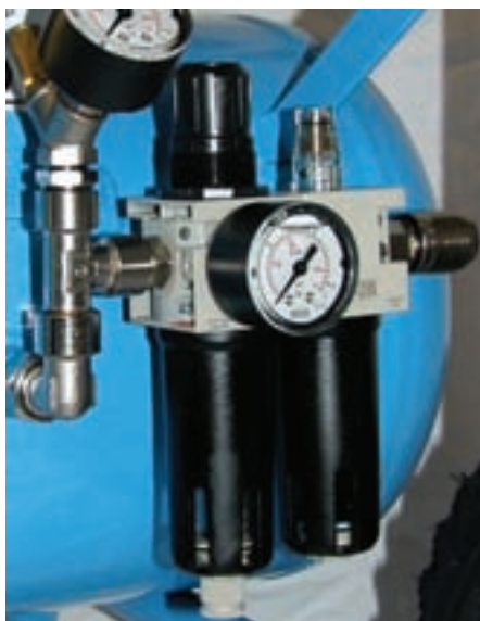
شکل ۱۳-۱- فشارسنج روی مخزن پمپ باد
