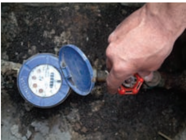
۱- بستن شیر اصلی بعد از کنترل آب
