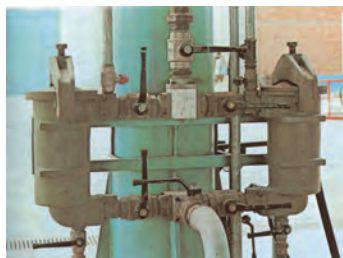
سیستم پمپ و تغذیه‌ی دوغاب
