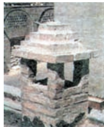
شکل ۳-۶- دودکش و هواکش در ساختمان
