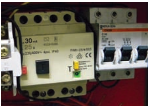
شکل ۱-۵- فیوز حفاظتی نصب شده در کارگاه
