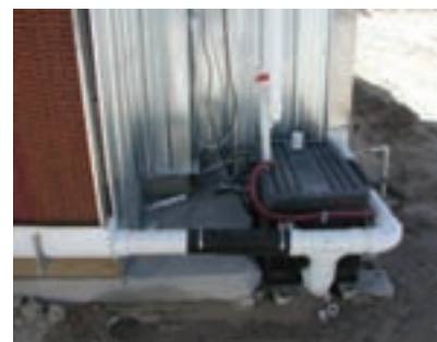
تصویر ۱۲-۲- پمپ و لوله های توزیع آب
