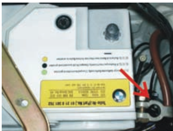
شکل ۲-۱۰۹- باز کردن اتصال منفی باتری
