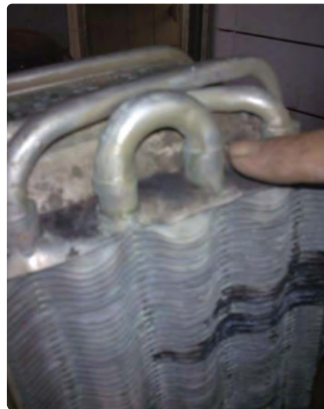
شکل ۴-۱۱- تشکیل رسوب در آب گرم‌کن
