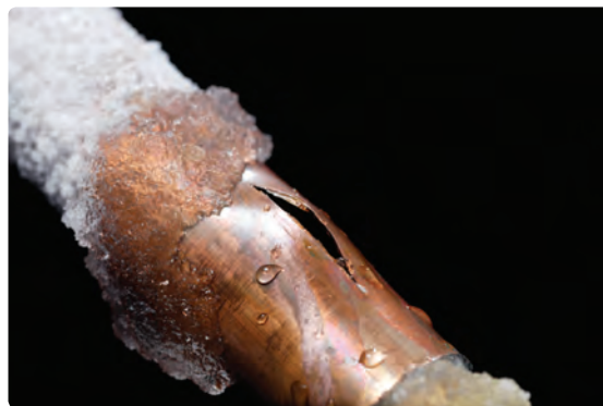
شکل ۴-۶- شکستن لوله آب در اثر انجماد آب
