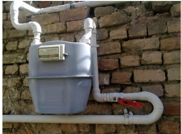
شکل ۸۱-۴ یک کنتور ۱۰ متری نصب شده
