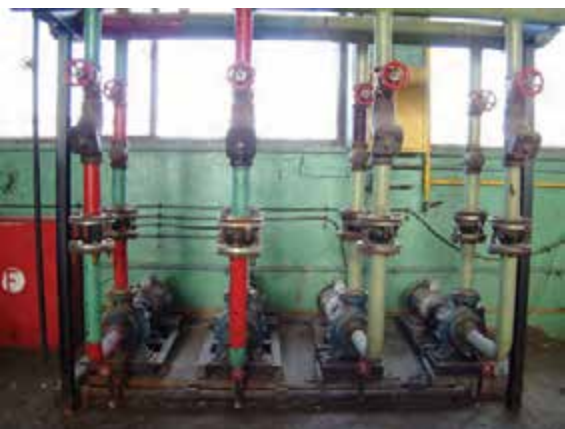
شکل ۳-۵- کاربرد لوله درزدار در لوله‌کشی شوفاز
