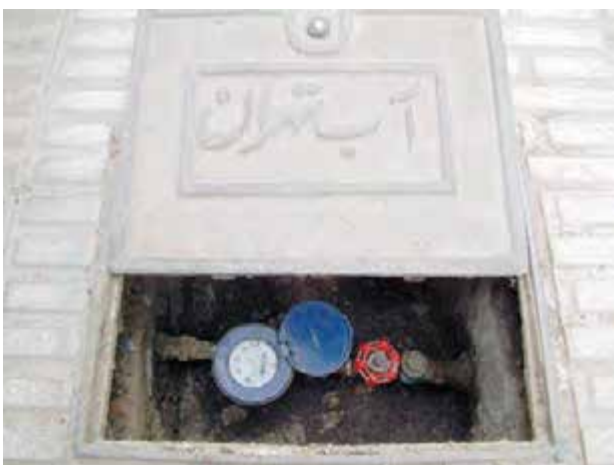
شکل ۴۶-۵ - استفاده از مهره ماسوره جهت اتصال کنتور آب به لوله‌ی آب سرد ساختمان
