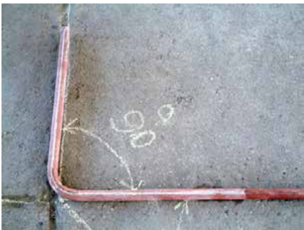
شکل ۳-۵۷- لوله‌ی خم کاری شده
