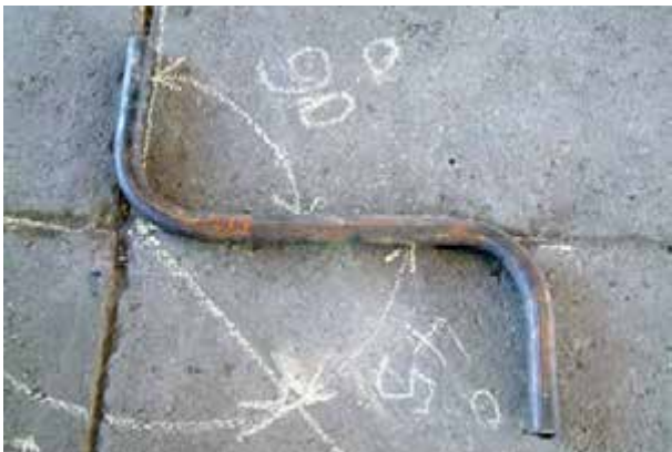
شکل ۳-۴۱- عدم دویدگی لوله‌ی دو خم
