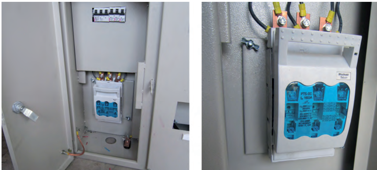
شکل ۲۳-۳- محل ورود کابل اصلی به داخل تابلو
