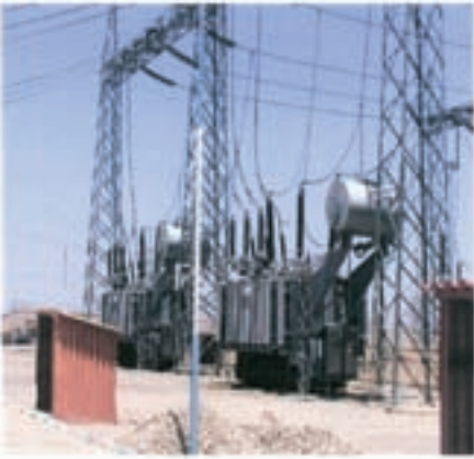
شکل (۲۸-۳) دو ترانسفورماتور موازی شده
