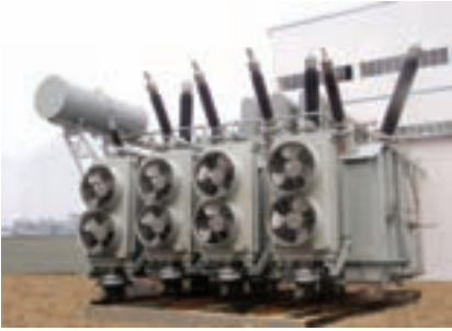
شکل (۳-۱) ترانسفورماتور خطوط انتقال
