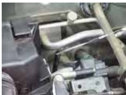
شکل (۲-۵۹) کنترل روغن
