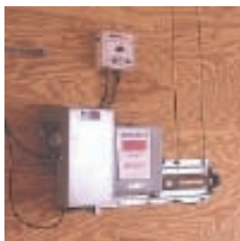
شکل ۳-۲۳- کنترل خودکار هواکش‌ها
