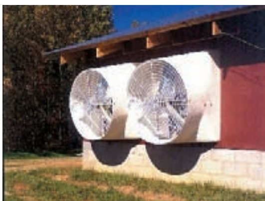
شکل ۱۸-۳- هواکش روی دیوارهای جانبی سالن پرورش طیور
