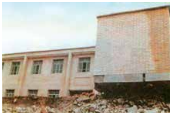
شکل ۱-۵۹- ساختمان دبستان روستای ناوه پس از زلزله
