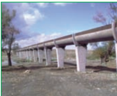
شکل ۴۵-۱- کانال انتقال آب (سیاه کمر)
