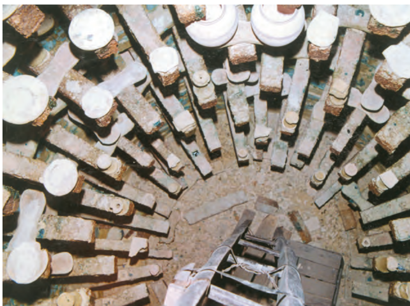
تصویر ۴- داخل یک کوره سنتی گازی
