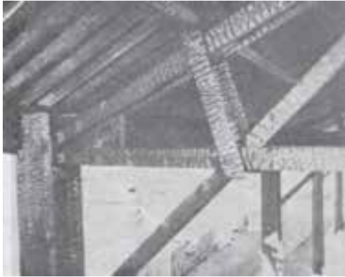
شکل ۲۶-۵-الف - این تیرهای چوبی در یک انبار نگهداری چوب آلات، پس از یک آتش‌سوزی شدید سالم ماندند چرا که لایه‌ی عایقی از زغال بر روی سطح آن ایجاد شده بود.
