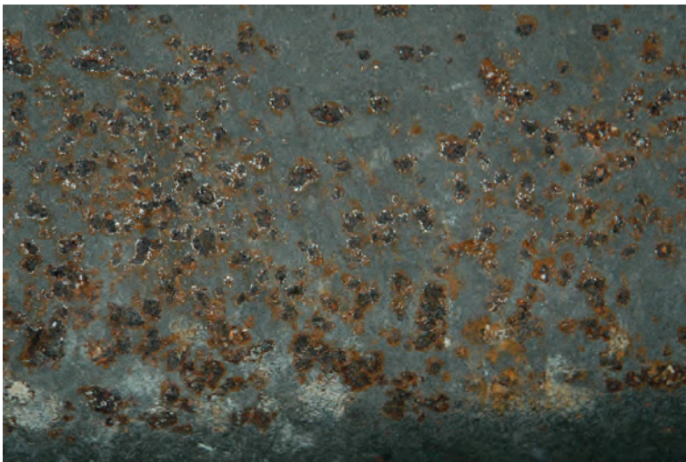
شکل ۱۴-۷- سطح فولاد دچار خوردگی موضعی (حفره‌دار شدن) شده است.
