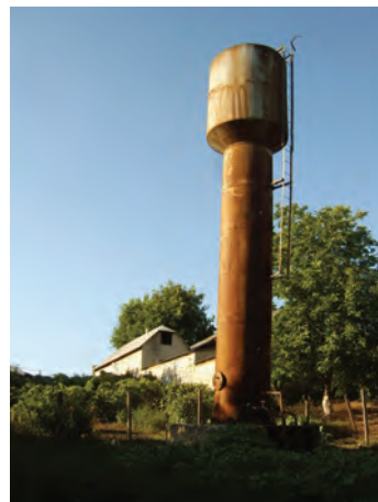
شکل ۷-۱- منبع آب در شرایط محیط دچار خوردگی شده است.
