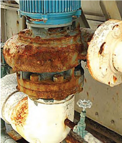
شکل ۲۵-۷- اتصالات خط لوله محتوی سیال خورنده به دلیل تماس قطعات با جنس‌های متفاوت دچار خوردگی شدید شده است.
