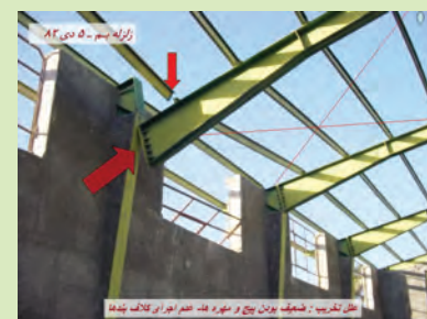
برش در پیچ‌ها، باعث گسیختگی اتصال در زمان زلزله شده است.
