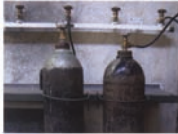
اتصال کپسول اکسیژن به خط لوله
