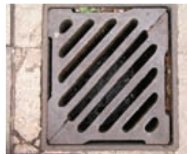
شکل ۱۰-۲ درب چاه های شهری از چدن
