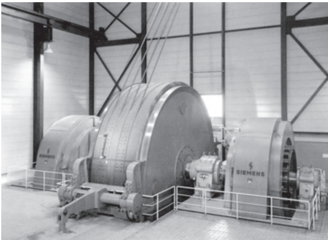
شکل ۱۳-۱۴ - ساختمان مخصوص جرثقیل [۳]
