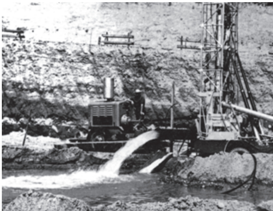
شکل ۷-۵- چاه عمیق با عمق بیش از ۳۰۰ متر
