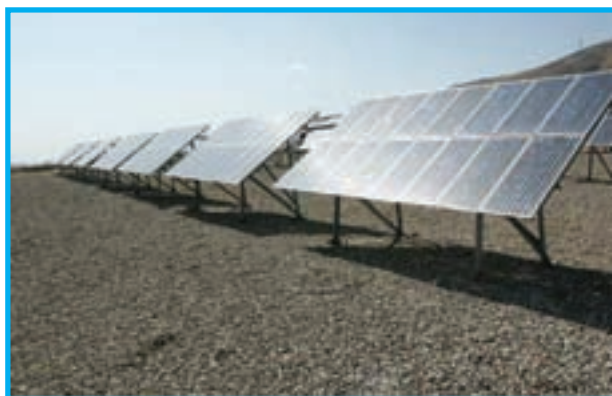
شکل ۱۰-۳ یک نیروگاه فتوولتاییک
